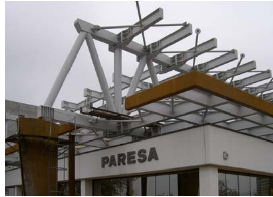
FASI DEL TRASPORTO E DEL MONTAGGIO DELLA STRUTTURA METALLICA TRANSPORT AND ERECTION OF THE STEEL STRUCTURE
